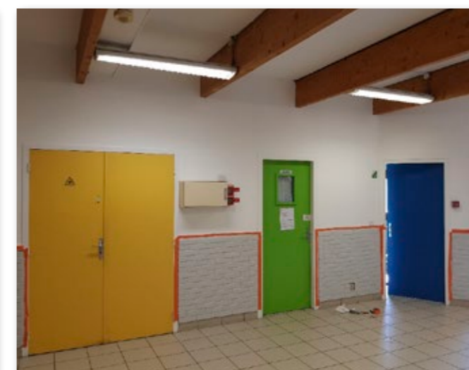
Le gymnase Paul Poisson en pleine rénovation intérieure avec des travaux de peinture, changement des radiateurs...
