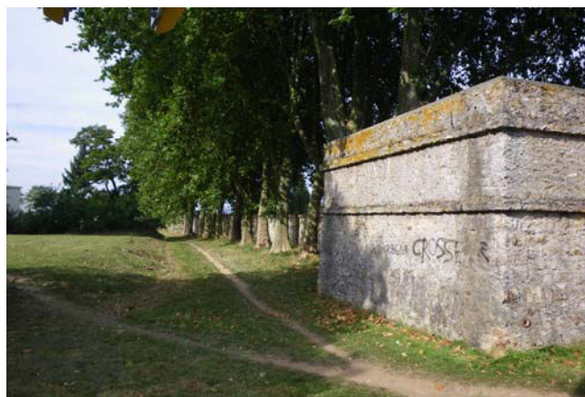
Siphon de la D 191, boulevard Charles de Gaulle [AQ-35]
